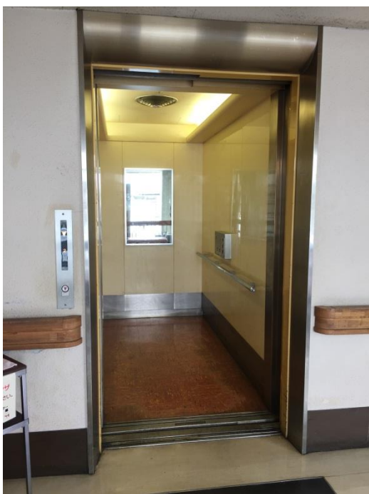
⑨エレベーター
